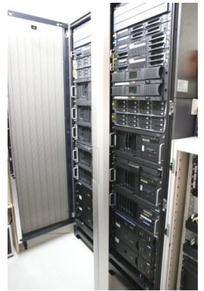
サーバー室 (たくさんのサーバーを管理しています)
